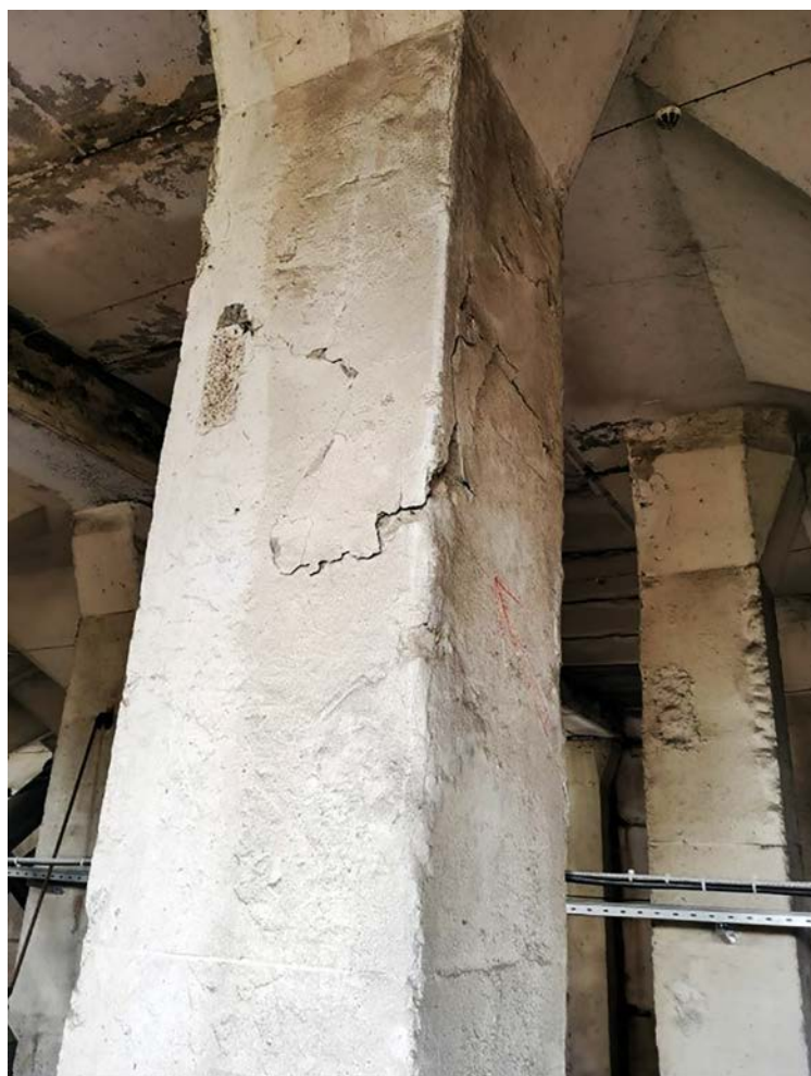
Рисунок 1 – Лещадка в бетоне колонны
